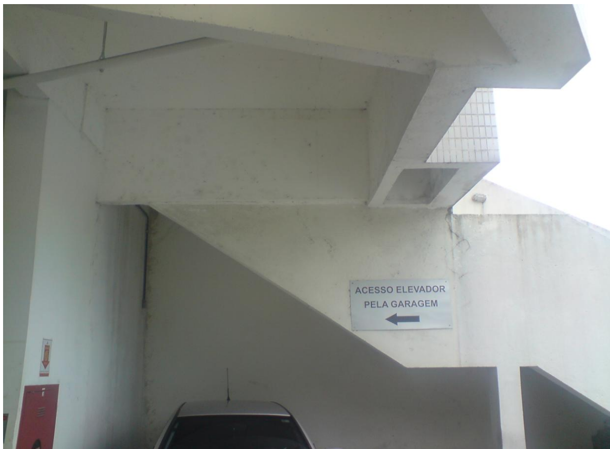
FOTO 19- EXEMPLO DE PAREDES QUE TERÃO QUE SER REPARADAS E PINTADAS (SERVIÇO 05)
