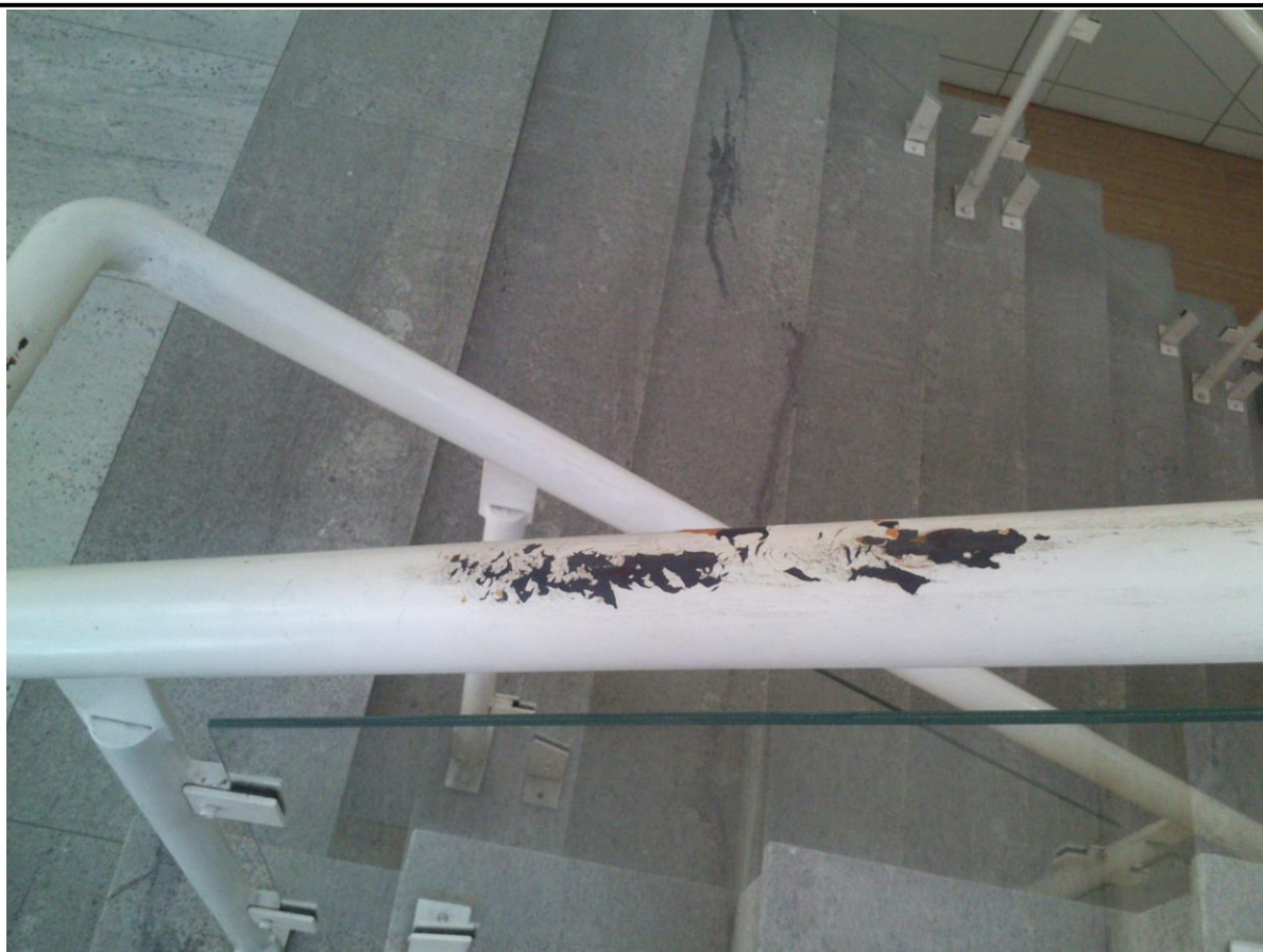
FOTO 23- EXEMPLO DE FERRUGEM PRESENTE EM CORRIMÃO INTERNO (SERVIÇO 06)
