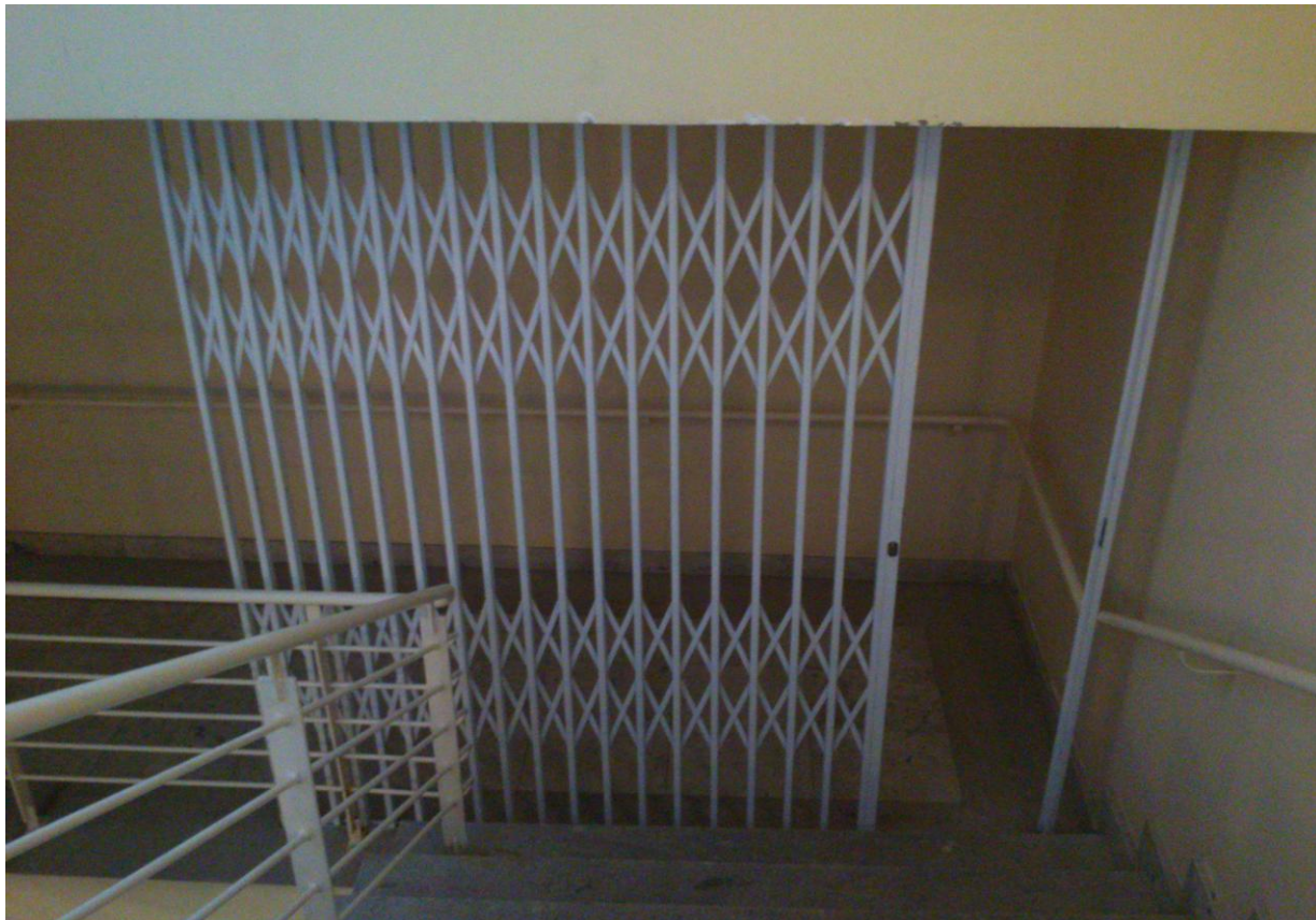
FOTO 25 – PORTA PANTOGRÁFICA (SERVIÇO 06)
