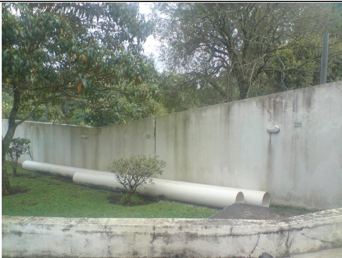
FOTO 16- EXEMPLO DE PAREDES QUE TERÃO QUE SER REPARADAS E PINTADAS (SERVIÇO 04)
