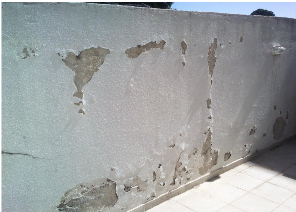
FOTO 12- EXEMPLO DE PAREDES QUE TERÃO QUE SER REPARADAS E PINTADAS (SERVIÇO 04)
