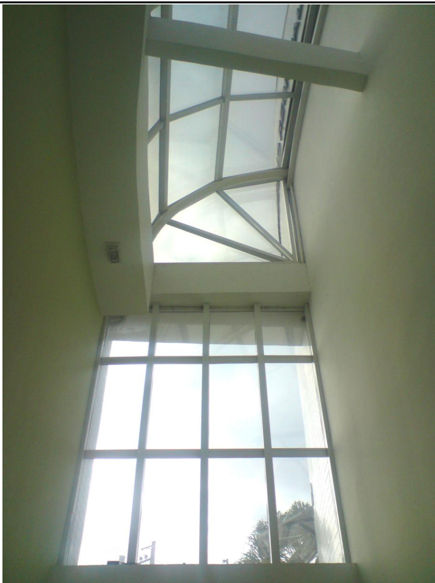
FOTO 29- RECORTES SUPERIORES PRÓXIMOS À PAREDE CURVA – PISO TÉRREO (SERVIÇO 06)
